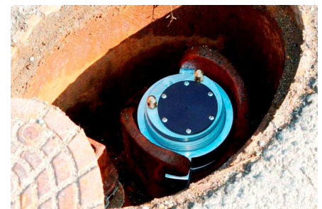
Sebalog P umiestnený v hydrantovej šachte
